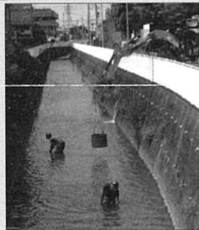
←中新田1丁目の 中央排水路の清掃を要望し実施
