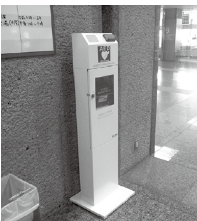
市役所エントランスホールに設置しているAED
